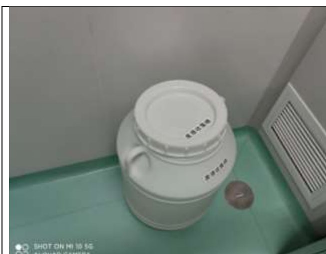
废液收集桶，洗涤液、洗脱液中和后进污水处理站
