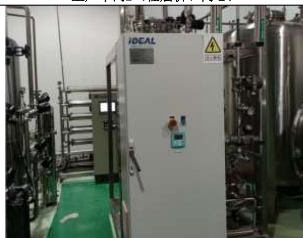
一楼纯水车间为降纤酶车间配套的纯水储罐系统
